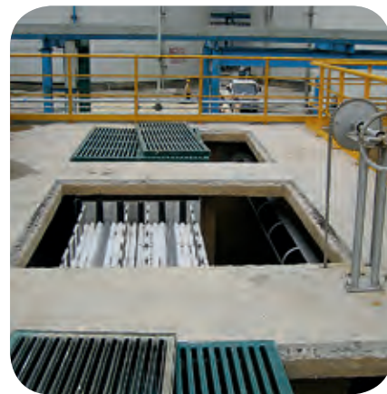
CPI beépítés burkolattal
